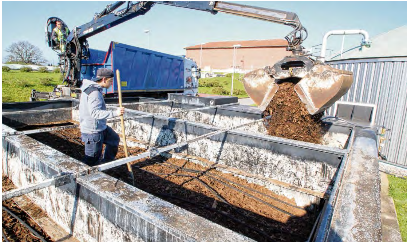
2017 wurde das Material der Biofilter erneuert. Nun ist es erneut bei allen drei Filtern ausgetauscht worden.
